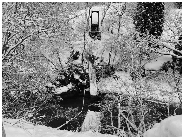
崩落した高坂橋
