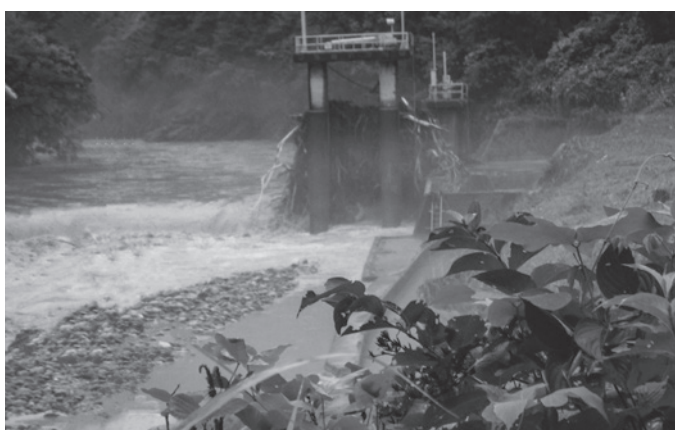
被災した井の下頭首工
