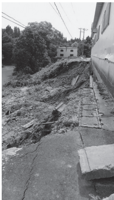
除雪センター裏 災害状況
