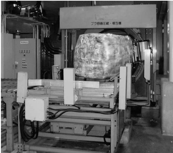
プラスチック資源の回収梱包機（千代田クリーンセンター）
