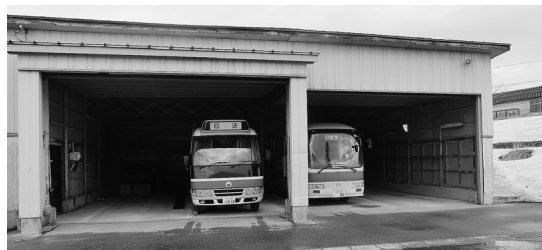
老朽化した町営バス車庫
