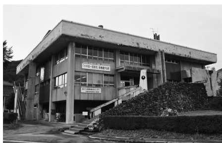
築50年も間近となり老朽化が進んでいる
