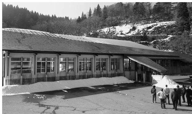
施設の腐食が進んでいた
