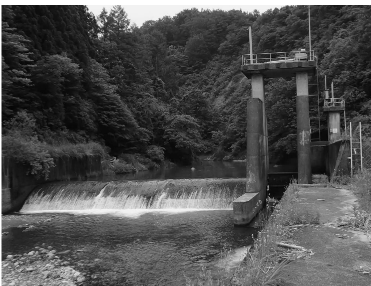
水源地の老朽化が進む「井の下頭首工」
