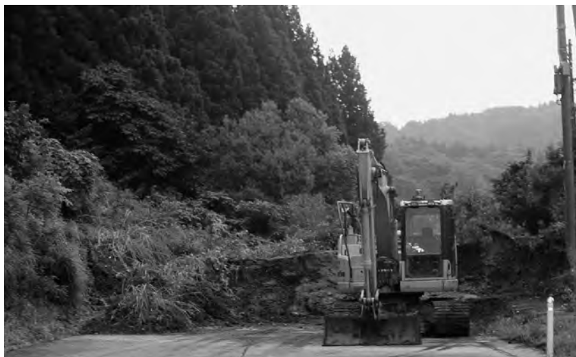
8月豪雨により町内各地に災害が発生した(市野沢地区)
