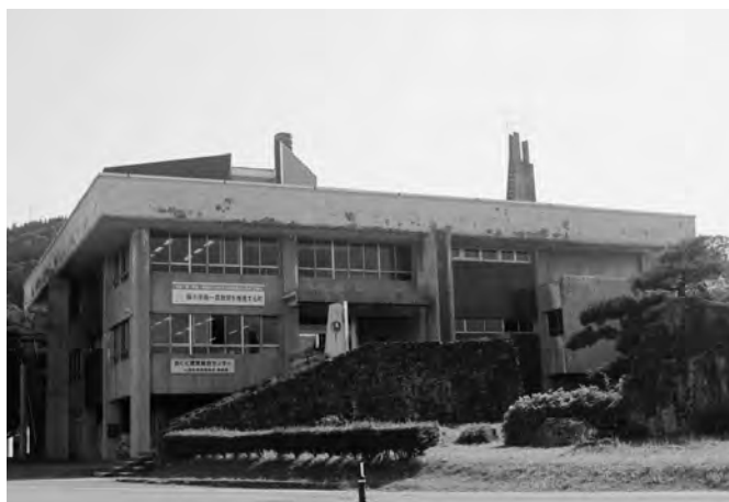
老朽化が進む総合センター
