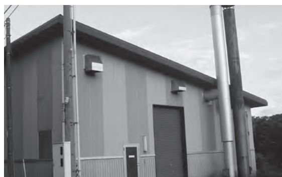
▼ 残材活用のチップボイラー施設
