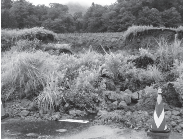
▲水稻作付水田の法面決壊（玉川中里地内）
