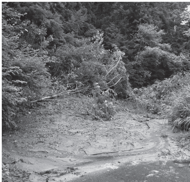
▲【林道樽口峠線】展望台樽口側700m地点 土砂崩れにより通行不可に
