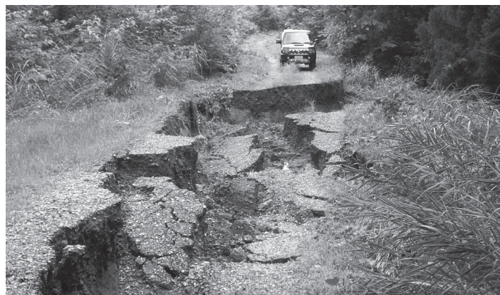
▲【林道田沢頭峠線】約70mに渡り崩壊
