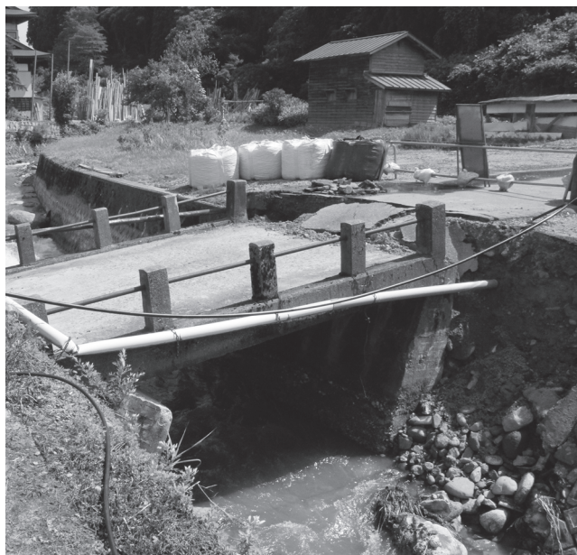
▲【町道小坂町朝篠線】黒沢地内大沢橋 橋脚がズレ落ち通行不可に
