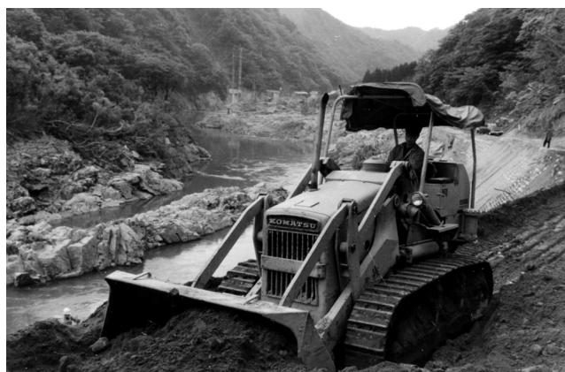
▲水害直後の国道113号赤芝地内
