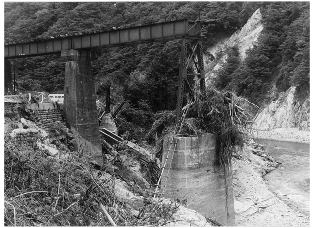
▲濁流によって流出した玉川第3鉄橋
