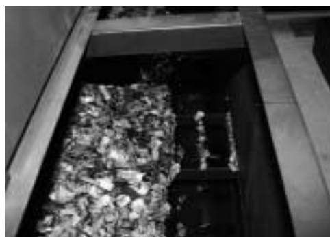
チップはスクリーンによって貯蔵施設からボイラーに運ばれる
