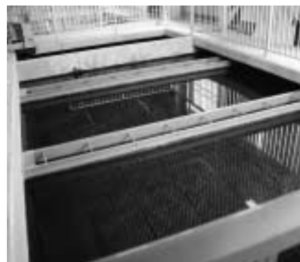
良質な工業用水を提供するための浄水施設
