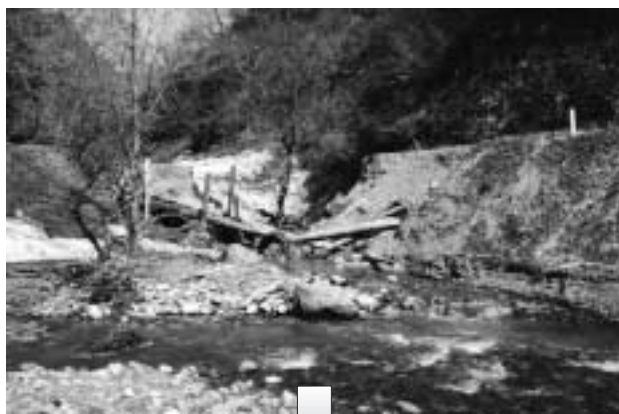
町道伊佐領川入線被災当時(伊佐領地内)
