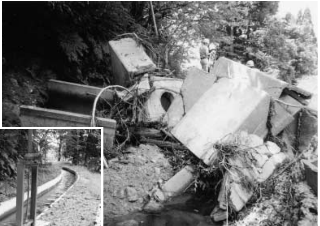
井の下幹線用水路被災当時（若山地内）
