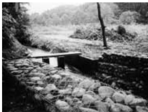
災害復旧後の用水路（田沢頭地内）
