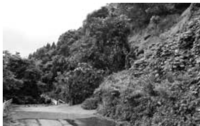
法面が崩落したことにより通行不能となった町道松岡大石線（18日）
