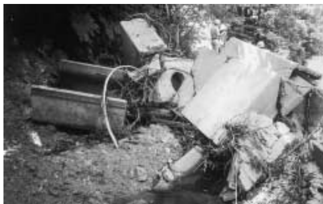
設備が崩壊した井の下幹線用水路（18日）
