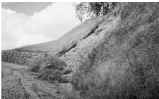
法面が崩落した林道大平峠線（18日）
