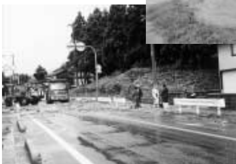
国道113号の土砂除去 作業（17日小国小坂町） ：渡辺英雄氏（小国小 坂町）提供
