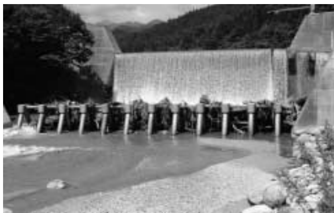
流木を受け止めた穴淵砂防堰堤
